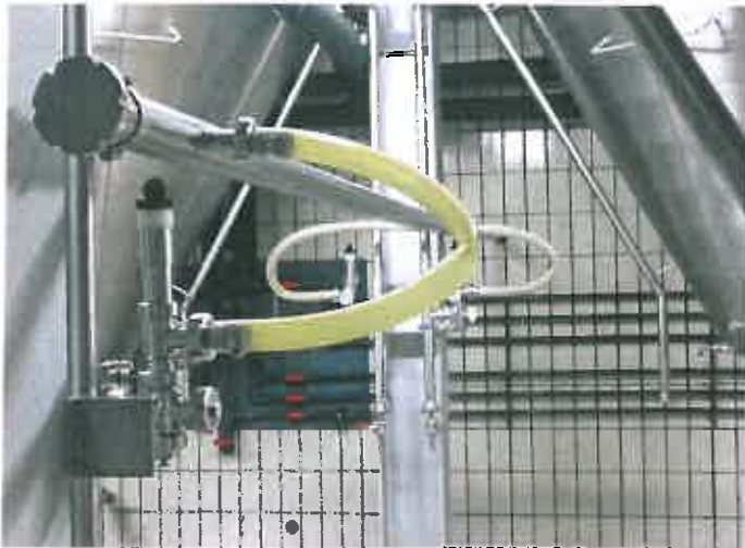
Ringleitung zum Ableiten von CO 2
