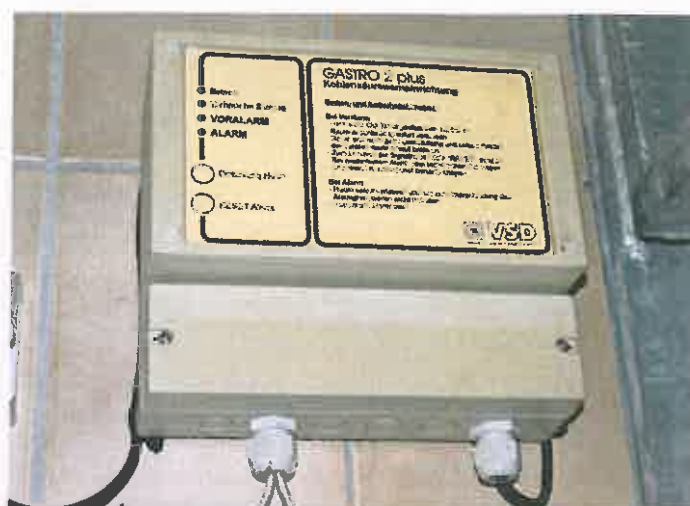
Stationäre CO 2 -Warneinrichtung
